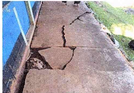
Foto 4: se observa el corredor de la escuela en mal estado
