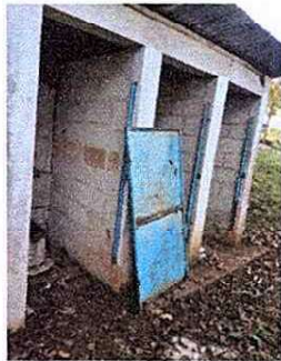
Foto 3: Los sanitarios requieren la colocacion de nuevas puertas
